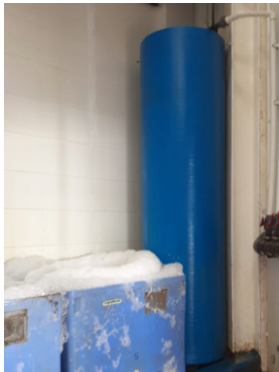
Filtro biológico de percolación de una depuradora.
