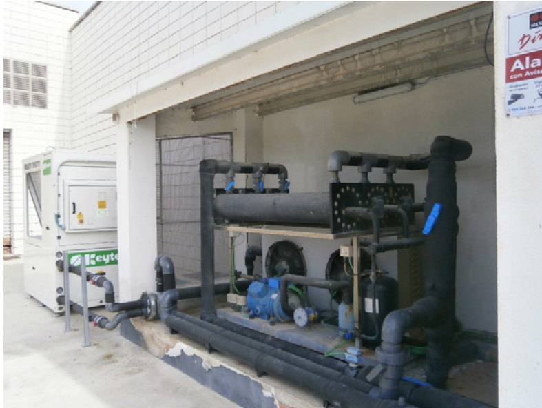
Sistema de refrigeración de una depuradora.
