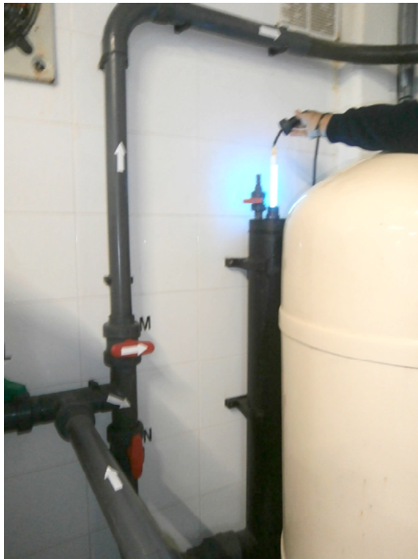
Lámpara UV dentro del sistema de desinfección del agua.
