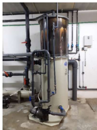
Skimmer de una depuradora.
