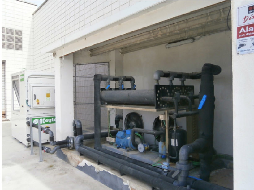
Sistema de refrigeració d'una depuradora.
