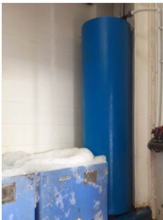
Filtre biològic de percolació d'una depuradora.
