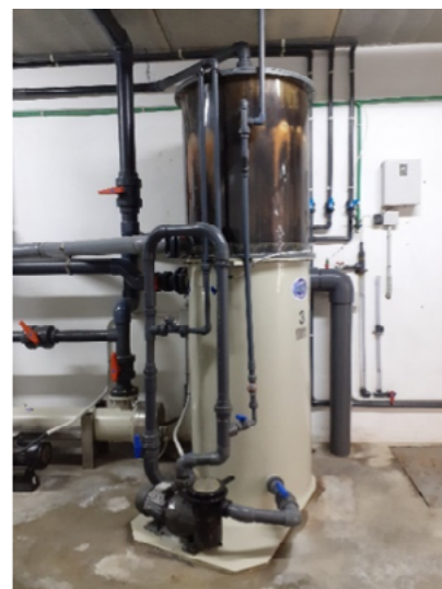
Skimmer d'una depuradora.
